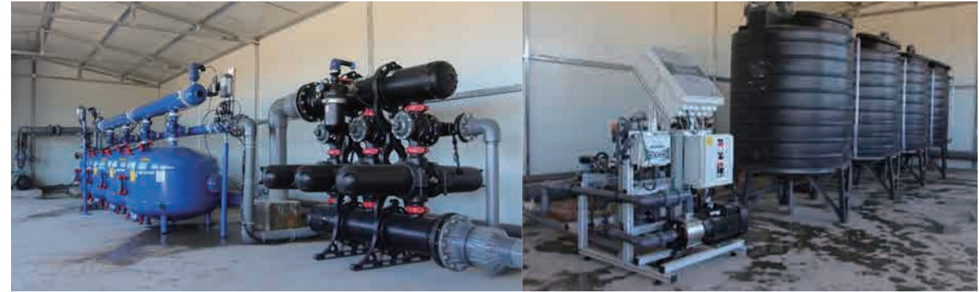
过滤系统、施肥系统和控制系统
