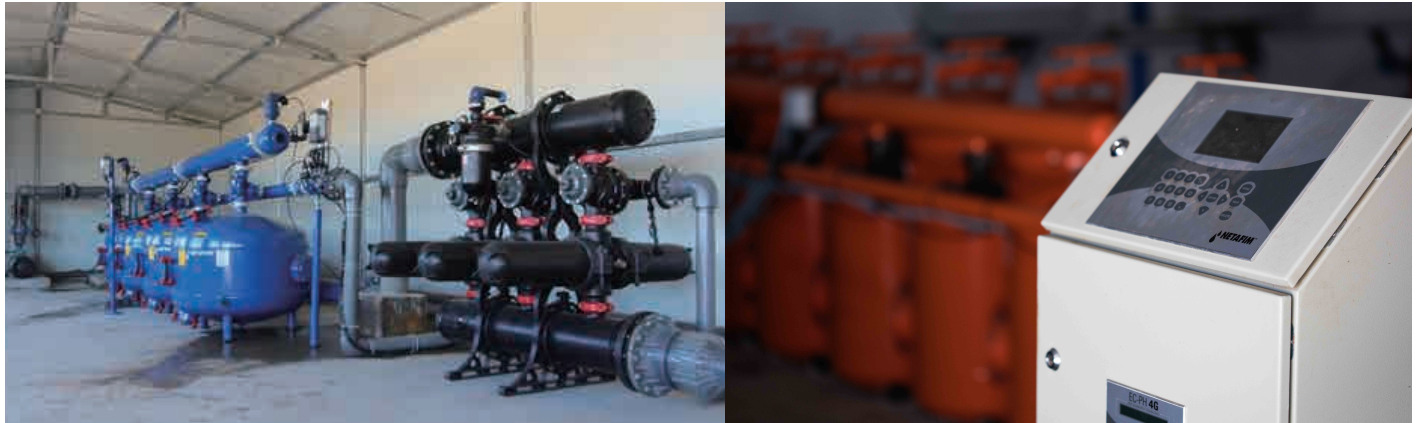
过滤系统、施肥系统和控制系统
