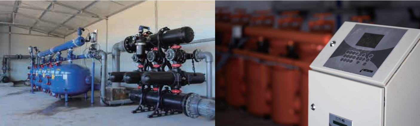
过滤系统、施肥系统和控制系统
