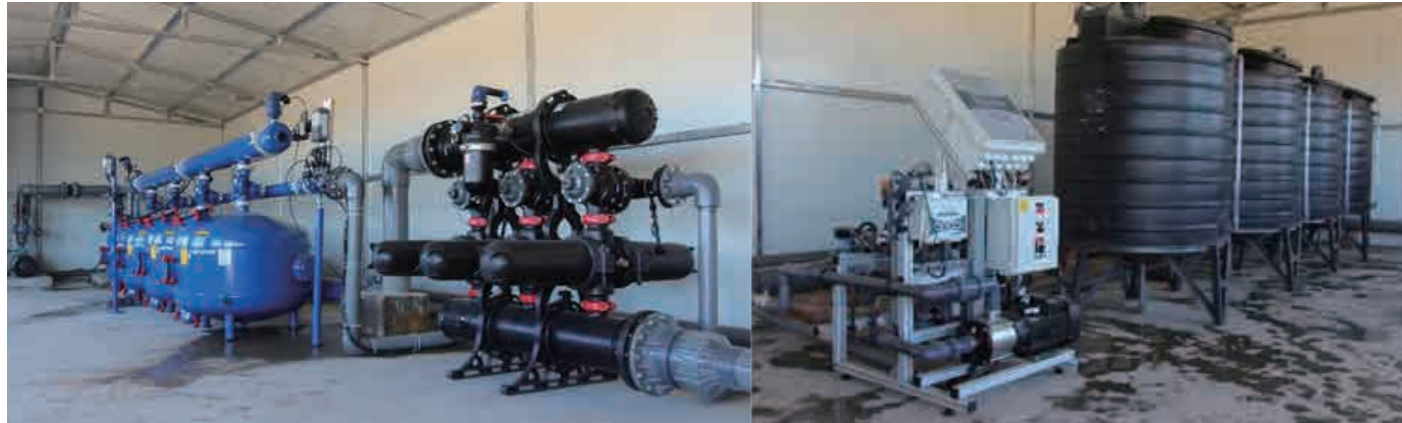
过滤系统、施肥系统和控制系统
