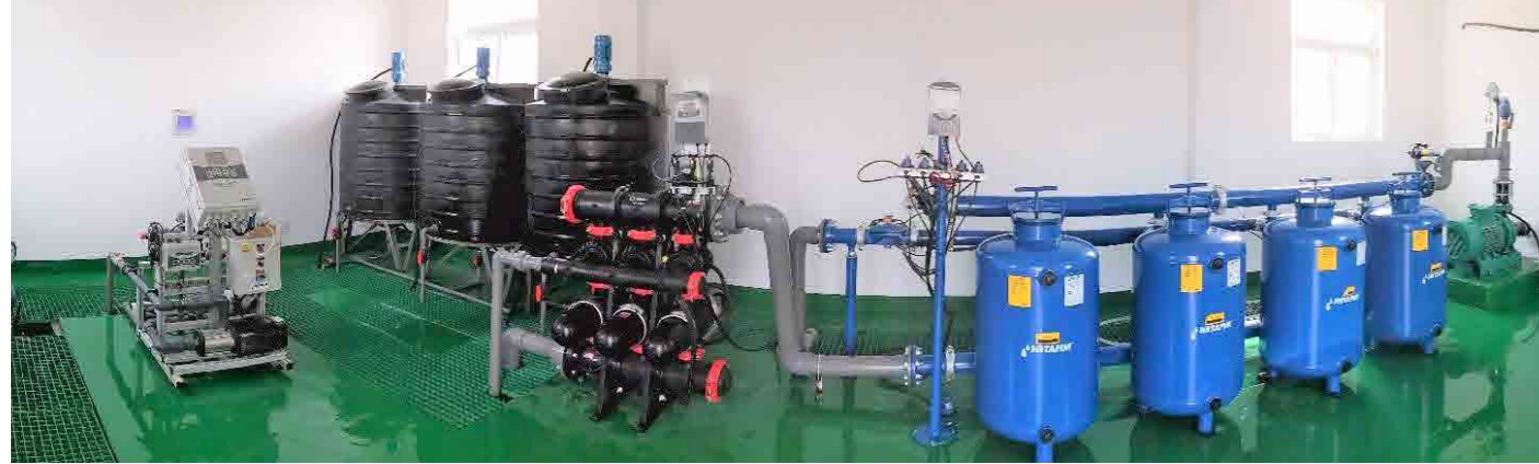
完整的首部管理系统：水泵、供电系统、阀门、过滤系统、配肥系统、水肥一体化管理系统
